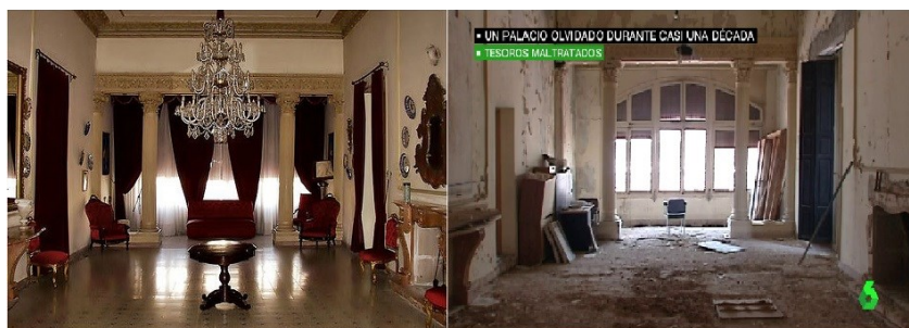
Figura 3. Interior del Palacio Rubalcava antes de la rehabilitación de la cubierta. enOrihuela.com.
